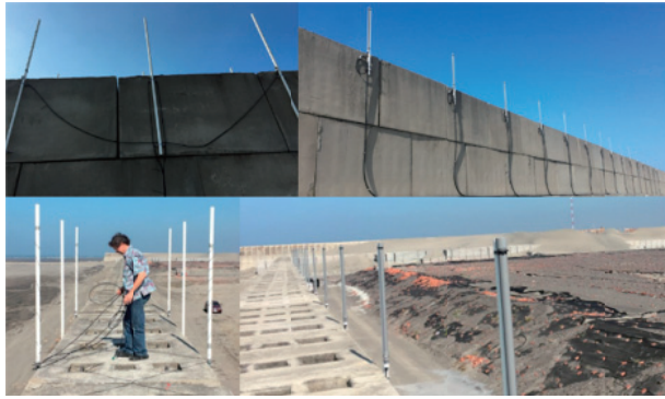
圖1 臺中港海洋高頻陣列雷達系統外觀現況
