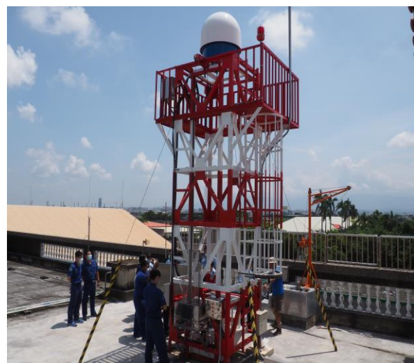
圖6 X-Band降雨雷達安裝在建築物屋頂。
